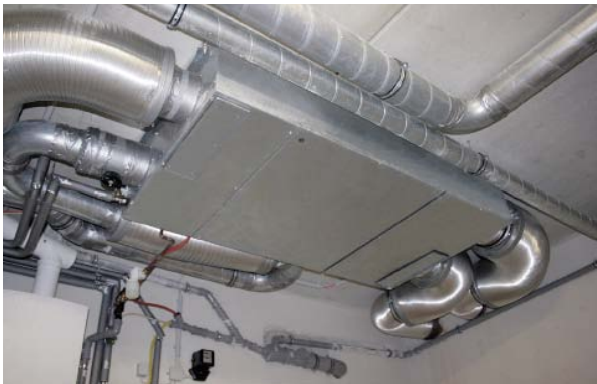
Afbeelding 3: Een bestaande plafondunit met indirecte verdampingskoeling.
